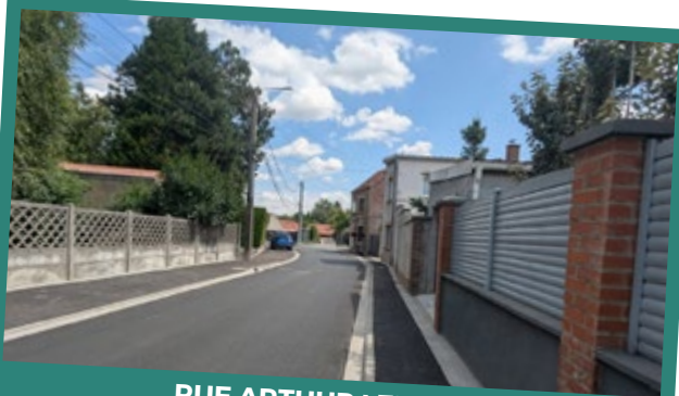
RUE ARTHUR LEROUX : fin des travaux avec la pose de l'enrobé définitif sur la chaussée et les trottoirs
